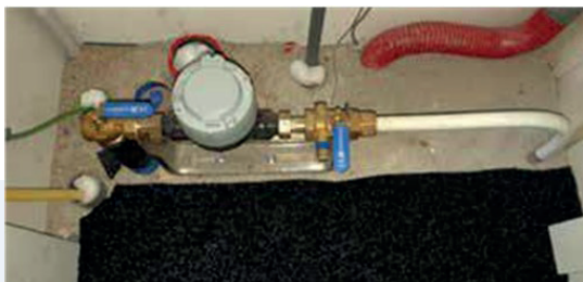
Waterleiding is afgesloten
