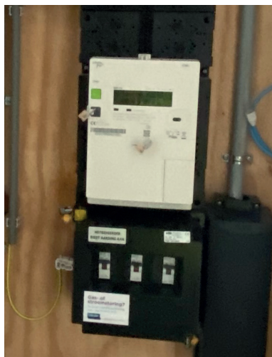
Dit is het deel van de netbeheerder: Liander. Dit is de elektra-meter met de 3 hoofdschakelaars
